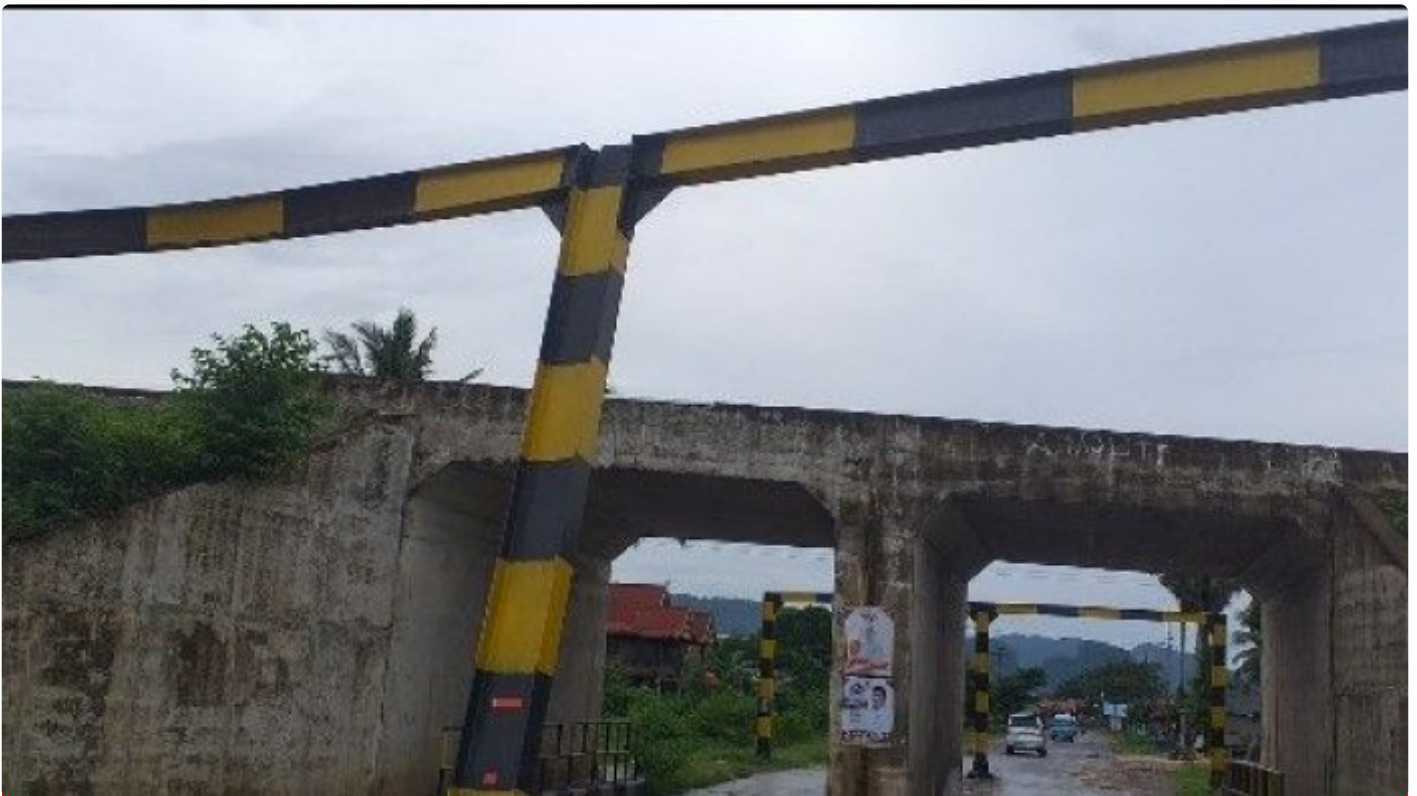
Pembatas Tiang Underpass Rel Kereta Api Jalan Tonasa Satu Soreang Baahayakan Pengguna Jalan
